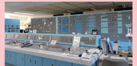
水処理センター
